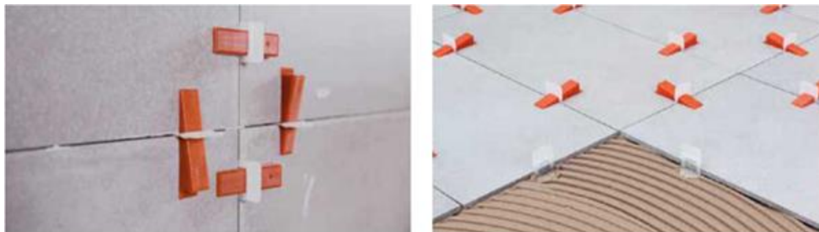
Пример использования системы выравнивания RLS при укладке плитки на стены и полы
